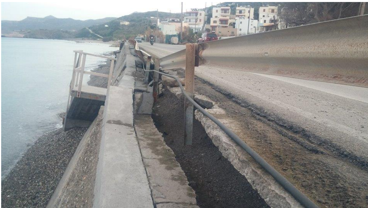
Εικόνα 3.4: Κατάρρευση παραλιακού δρόμου (χειμώνας 2016)
